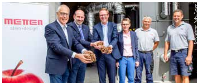
Das wollten sich auch der Bundestagsabgeordnete Dr. Hermann-Josef Tebroke und Overaths Bürgermeister Christoph Nicodemus anschauen: Inbetriebnahme der neuen Wärmanlage durch Geschäftsführer Michael Metten (Dritter von links).
